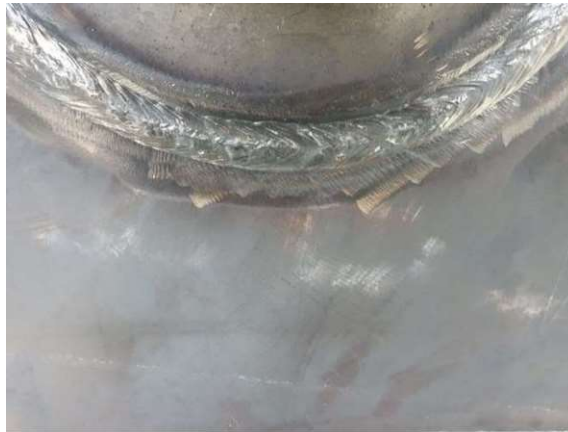
Figura 26 - Junta realizada de forma correta
