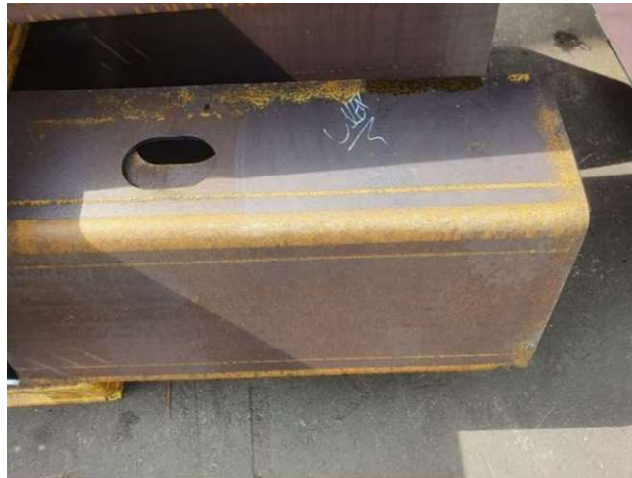
Figura 24 - Oxidação na superfície da chapa
