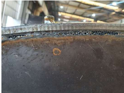
Figura 27 - Junta com Descontinuidade
