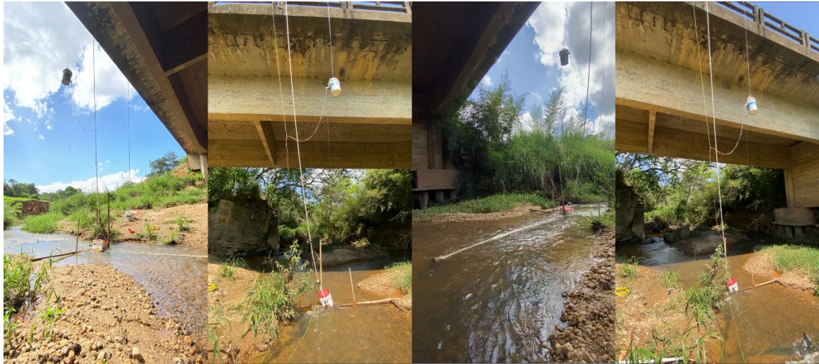
Figura 42 - Instalação final do circuito na ponte com sensor de nível a 2,75 metros do rio
