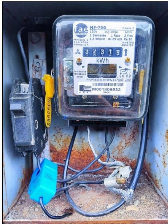
Figura 8 - Sensor SCT-013 instalado no relógio
